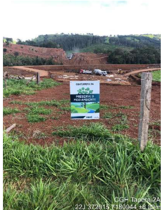
Figura 16 - Placa instalada na CGH Tapera 2A.
