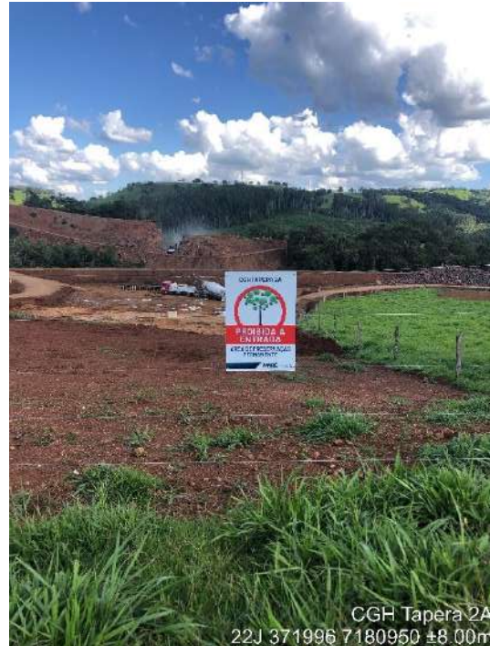
Figura 20 - Placa de proibida a entrada instalada na CGH Tapera 2A.
